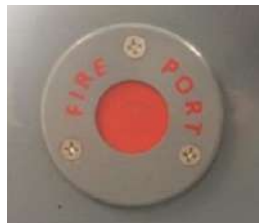
Feuerlöschöffnung auf der Backbordseite der Konsole
