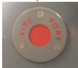
Orificio de extinción ubicado en el lado de babor de la consola.
